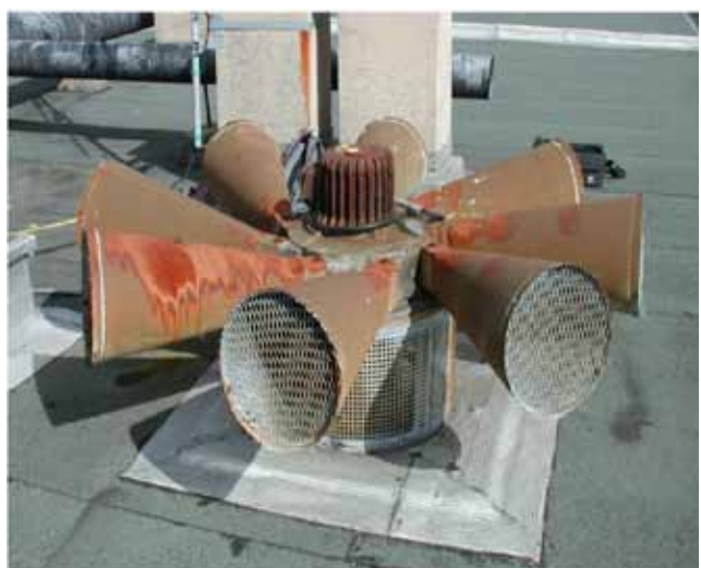
Etat fréquent des sirènes de l'ancien réseau RNA
